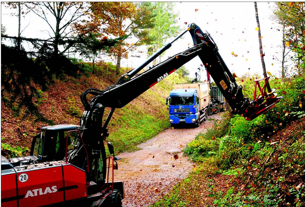
Gebüsch und Bäume, die gerade im Winter den Verkehr zwischen Altenthann und Adlmannstein beeinträchtigen, wurden am Mittwoch großzügig entfernt. Die Räumungsaktion war an einem Tag erledigt. (Foto: Schlicksbier)
