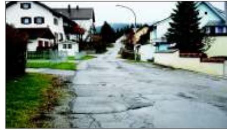
Die Asphaltdecke ist in marodem Zustand , eine Straßenentwässerung gibt es nicht, deshalb soll die Straße in die Klotzersiedlung ausgebaut werden. – Foto: Schlenz
